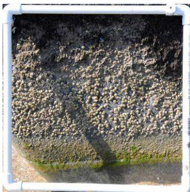
Photo 17 : Balanes sur le pourtour des blocs.
